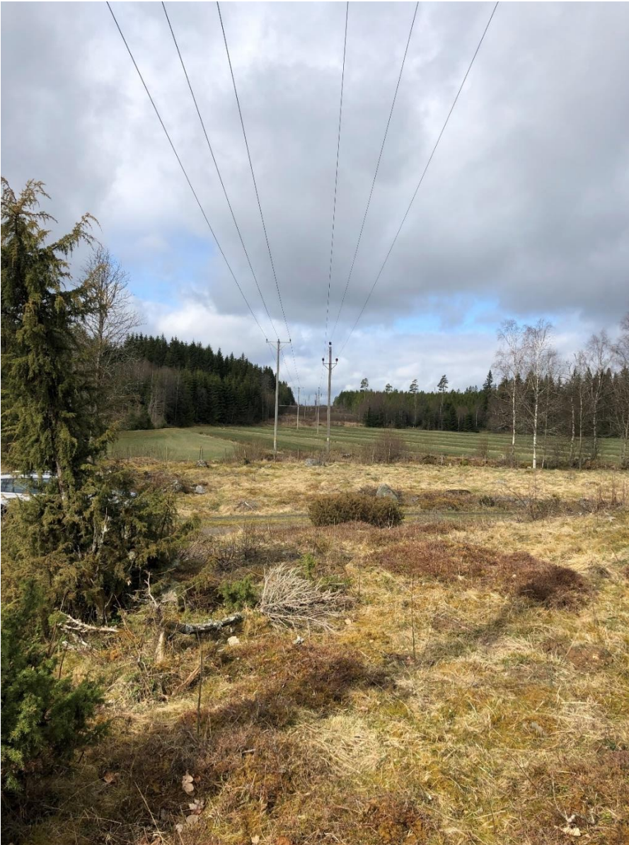
Bild 5: 40 kv-ledning och 10kv-ledning med regel mellan stolparna.
