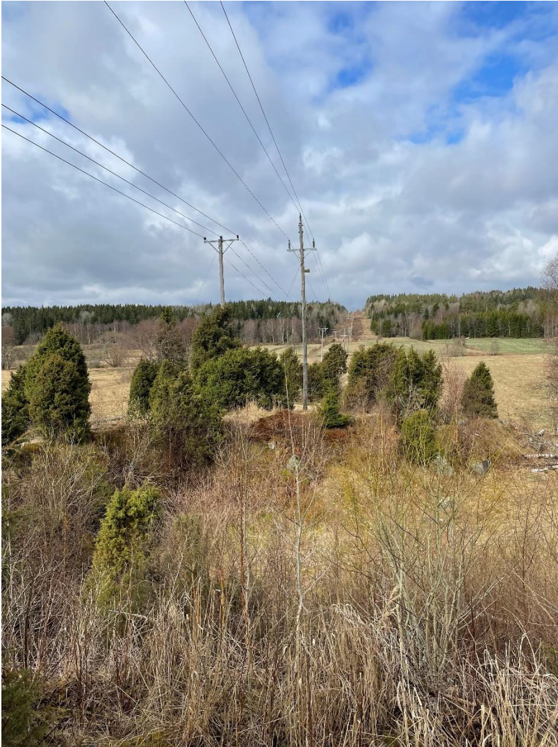
Bild 7: Foto nära Lindås station (utanför Liared) ledningen går mot Ulricehamn. 40 kV ledningen (vänster i bild) går parallellt med 10 kV ledning (höger i bild)
