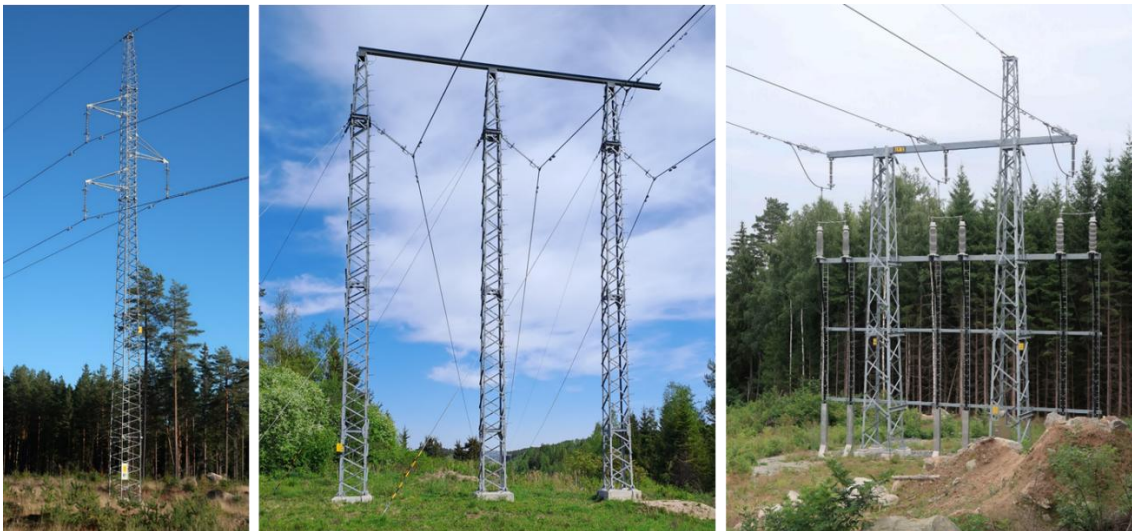
Figur 2. Enbent gitterstolpe med vertikalt hängda faslinor samt en topplina till vänster. Trebent vinkelstolpe med horisontellt hängda faslinor samt en topplina i mitten. Kabeländstolpe med horisontellt hängda faslinor samt en topplina till höger. Foton: Göran Olsson, Sweco Sverige AB.
