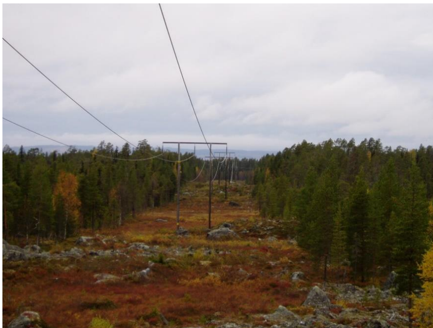
Figur 1. 130 kV luftledning i regionnätet, trädsäker.
