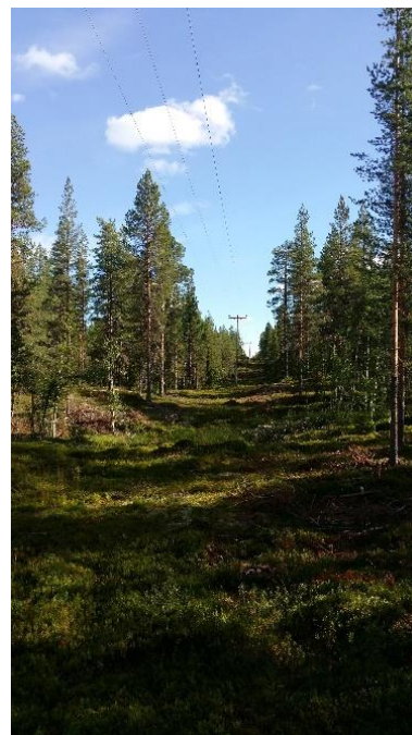
Figur 2. 20 kV luftledning i lokalnätet, ej trädsäker.
